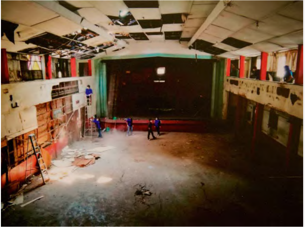
พื้นที่ภายในโรงภาพยนตร์ที่กว้างขวางและมีความสูงเพียงพอที่จะปรับปรุงเป็น ๒-๓ ชั้น The spacious interior of the theatre, with sufficient height for a 2-3 storey renovation.
