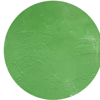
Uneven finishing พื้นผิวไม่เรียบ
