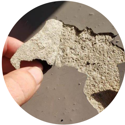
Peeling พื้นหลุดล่อน
